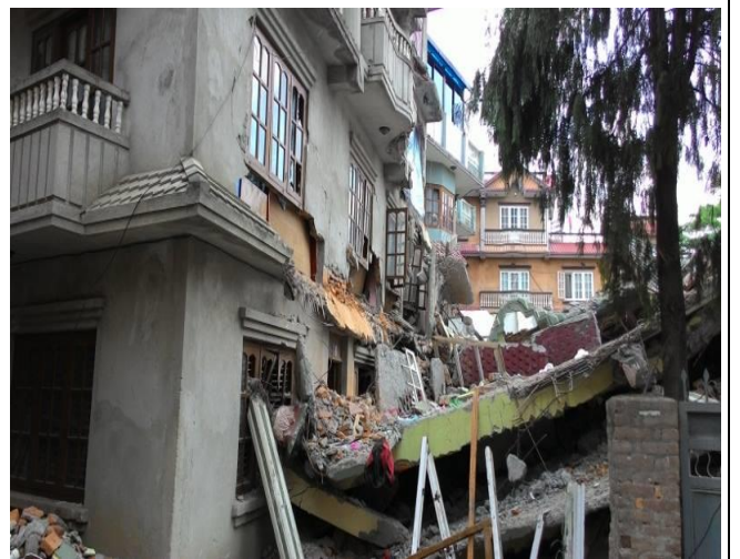
尼泊爾地震後原本三層樓的住宅已成廢墟
